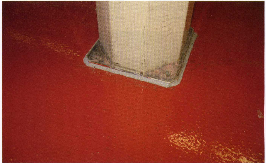
Bevestigingen op een vloeistofdichte vloer moeten zijn afgedicht (op enkele uitzonderingen na).
